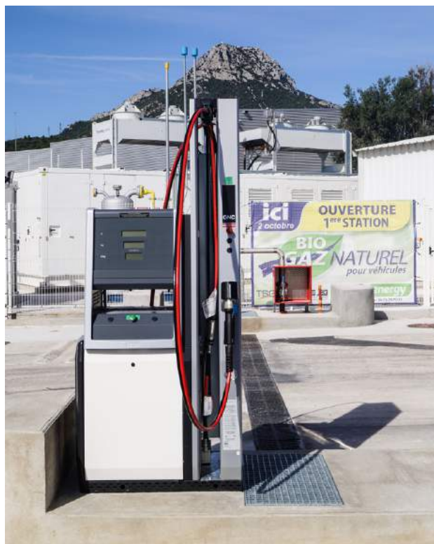
Station K9 ENERGY à la Garde dans le Var
